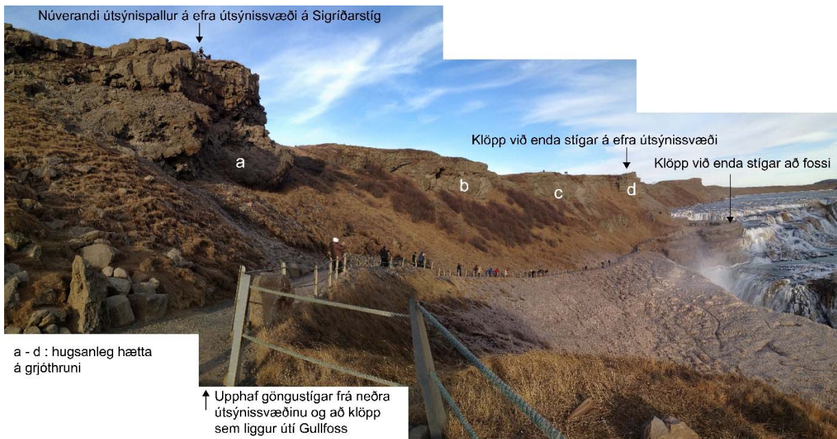
Mynd 6: Skýringamynd sýnir stíg sem liggur meðfram hlíðinni frá neðra útsýnissvæði og niður að klökk sem liggur út í fossinn og hugsanlegar hættur á grjóthruni. Ljós.: Margrét Pálsdóttir, nóvember 2012.
