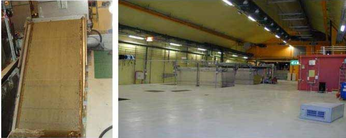
Figur 4.24 Hølen RA med kanalmontert båndsil (Sobye filter) i forsøkslinje
