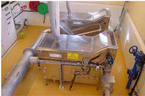
Figur 4.21 Skjærvika renseanlegg med to silmaskiner av typen Soby Miljøfilter
